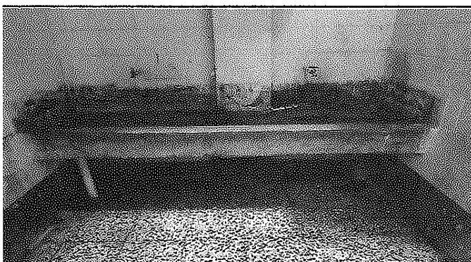
Foto 16: Lavamanos y chorros en sanitario de niñas en mal estado.
