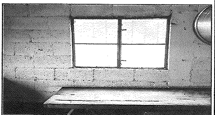
Foto 6: Ventana con poca iluminación y poca ventilación
