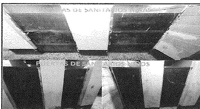
Foto 18: Puertas de baños oxidadas y deterioradas.
