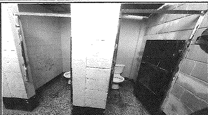
Foto 13: Sanitarios deteriorados e infuncionales.
