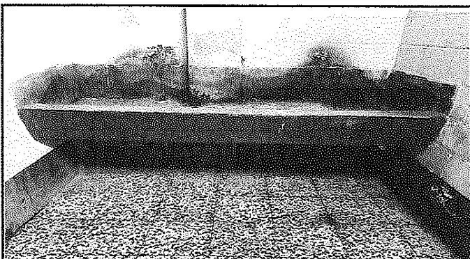
Foto 15: Lavamanos y chorros en sanitario de varones en mal estado.
