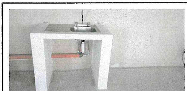
Instalación de lavatrastes en el área de cocina
