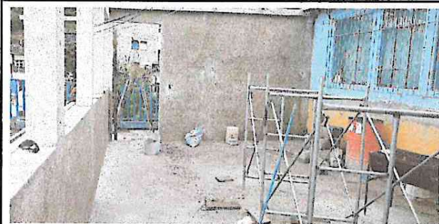
Foto 5: Drenaje de cocina en malas condiciones
