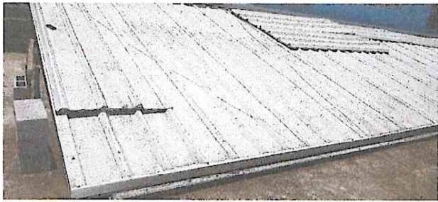
Foto 1: Malas condiciones de drenaje
