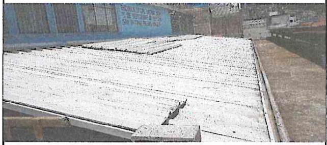
Foto 2: Malas condiciones del drenaje desde otra perspectiva
