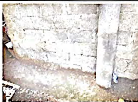
Foto 8: Repello de pared donde que se encuentra en la parte de atrás de la cocina, en este lugar se filtra el agua en época de invierno.
