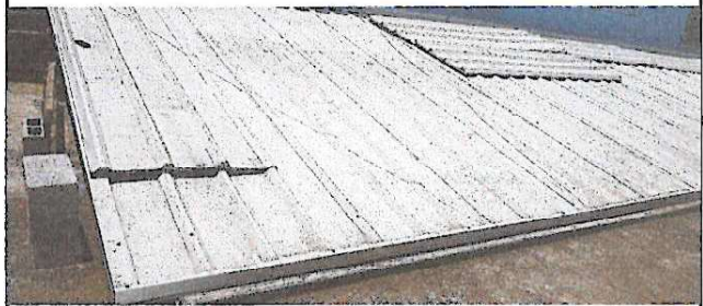
Foto 2: Techo para cocina desgastado
