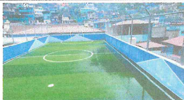
Foto 2: Cancha inundada por lluvia.
