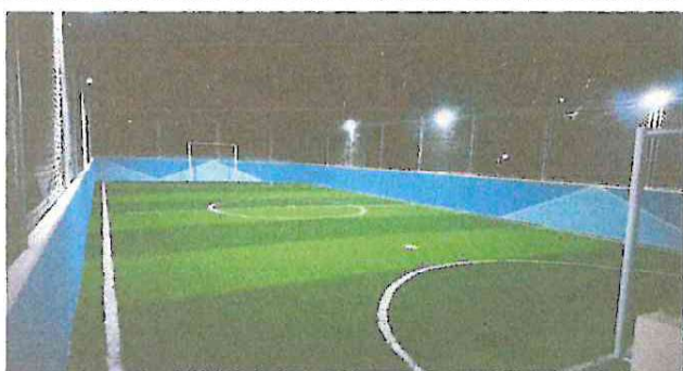
Foto 3: Alumbrado de cancha expuesto a las lluvias por falta de protección.
