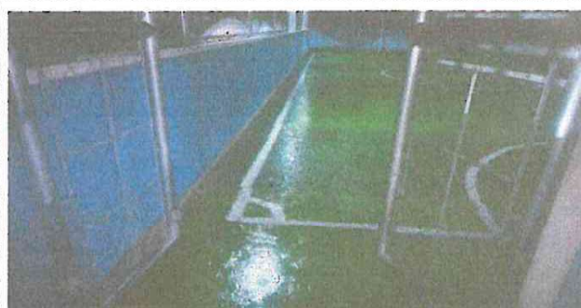
Foto 4: Cancha inundada por falta techo.
