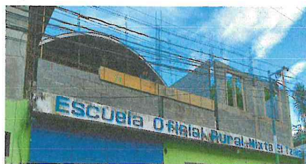
Foto 2: Pared de la parte exterior de la escuela con muro de pared y con peligro a cableado de alta tensión.
