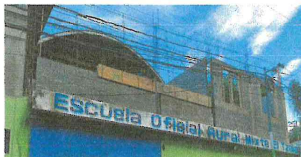
Foto 2: Pared de la parte exterior de la escuela con muro de pared y con peligro a cableado de alta tensión.
