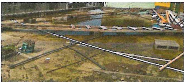
Foto 5: Otra vista de losa de patio deteriorada y acumulación de agua.
