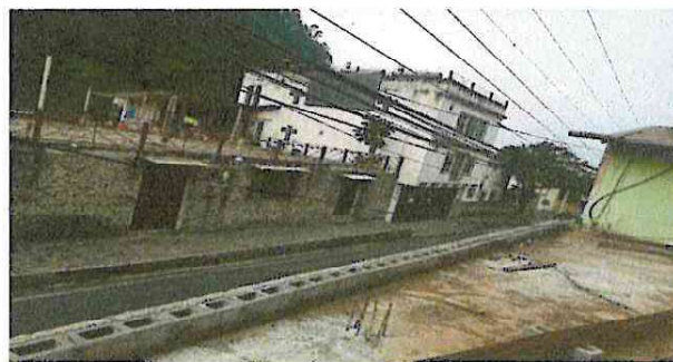
Foto 2: Pared sin muro y con exposición a cable de alta tensión.
