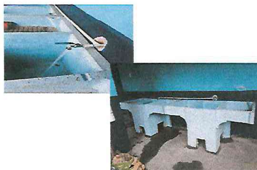
FOTO 4: PILA INSTALADA Y FUNCIONANDO
