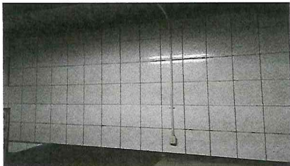
FOTO 6: AZULEJO INSTALADO PARED CON MOHO
