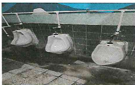
FOTO 3: SERVICIOS SANITARIOS Y MINGITARIOS INSTALADOS
