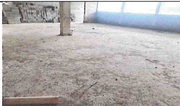
Foto 2: solo cuenta con torta de cemento
