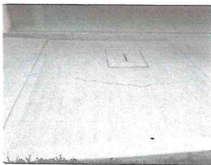
Rajaduras en el patio
