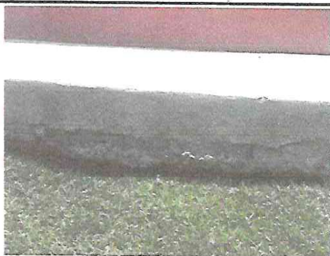
Socavamiento en patio y la rampa de acceso
