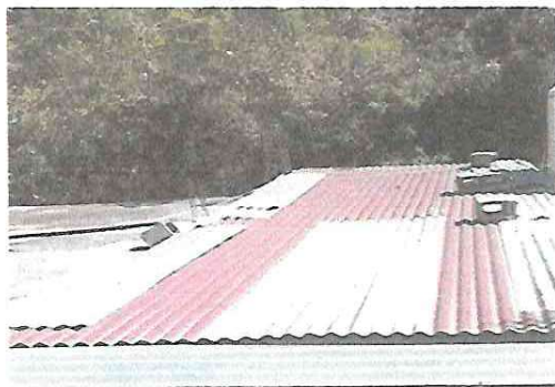
Parte del techo con filtraciones
