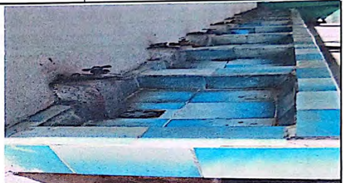
Foto 14: Llaves de choros que serán sustituidas por tener mal funcionamiento.
