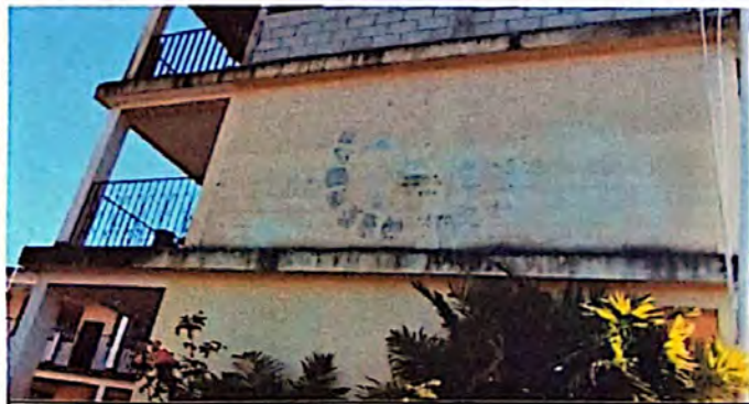
Foto 11: Pintura en pared exterior de aulas.
