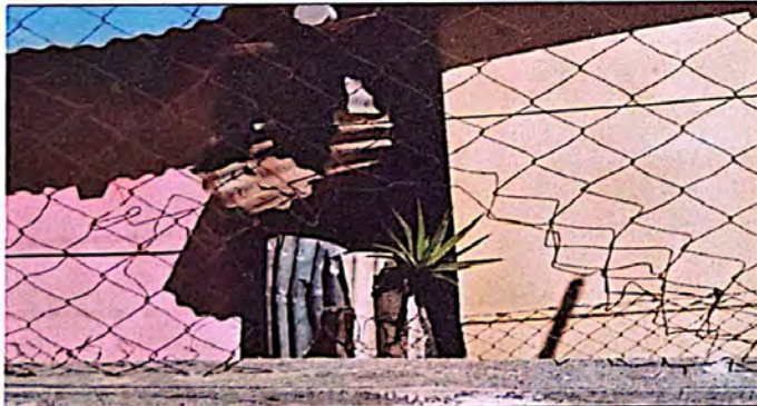
Foto 15: Malla perimetral que presenta agujeros en una extensión de 8 metros lineales
