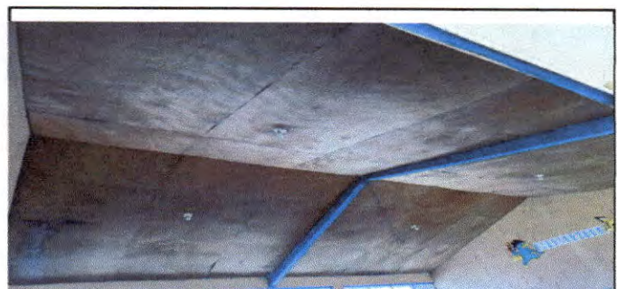
Foto 12: CIELO FALSO CON HUMEDAD
