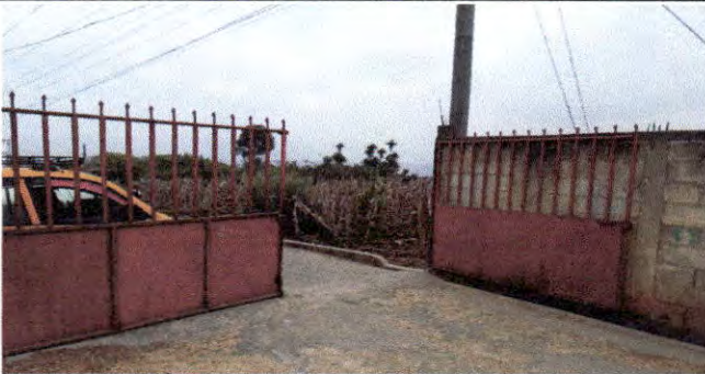
Foto 7: PORTON EN MAL ESTADO CON CORROSIÓN Y CAÍDO
