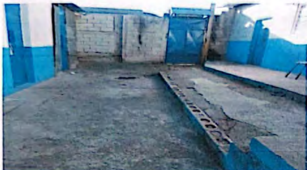
Foto 7: patio en mal estado, necesita reparación
