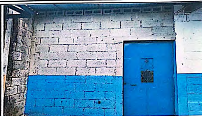
Foto 2: Pared en mal estado, necesita mantenimiento
