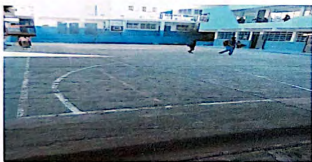
Foto 9: Cancha en mal estado necesita mantenimiento
