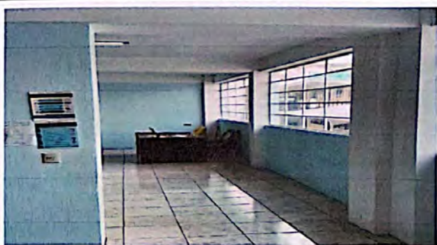
Foto 5: Dirección no cuenta con una puerta
