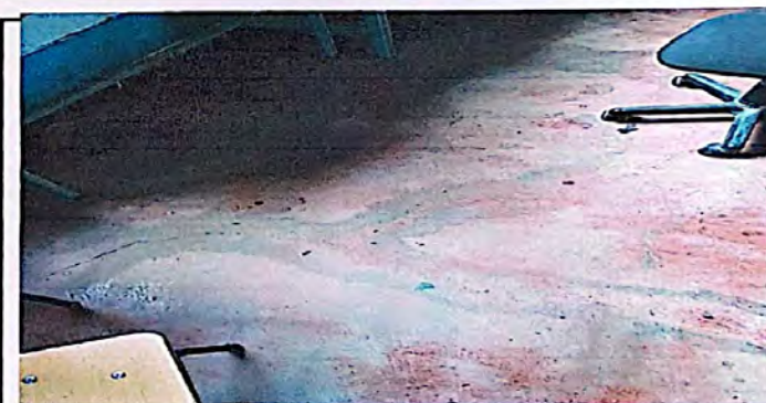
Foto 4: Piso en mal estado
