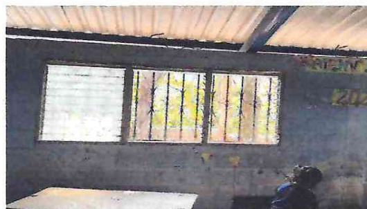
Reparación de 36 ventanas con vidrios para evitar el polvo. Se necesita pintar las paredes de 7 aulas de la escuela. Es urgente la reparación de los espacios bajo el techo para mayor seguridad.
