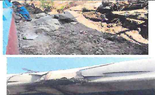
Se necesita la ampliación de un muro detrás de las aulas de párvulos y de preprimaria para evitar deslave, también es urgente el cambio de canales de agua de las láminas de las aulas.
