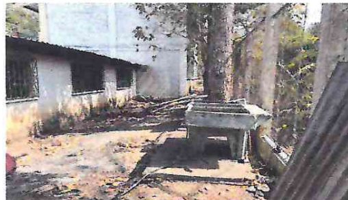
1. se necesita una galera de la pila 2. la parte atrás de las 5 aulas se necesita pavimentar, para evitar lodos y deslave en la temporada de invierno.
