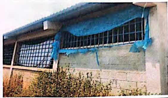
AULAS: sin ventanas
