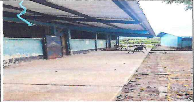
Techo sin canal pluvial
