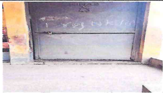
Puertas de servicio sanitario en mal estado
