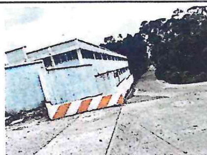
Foto 4: Muro perimetral sin seguridad para el acceso, lado sur.
