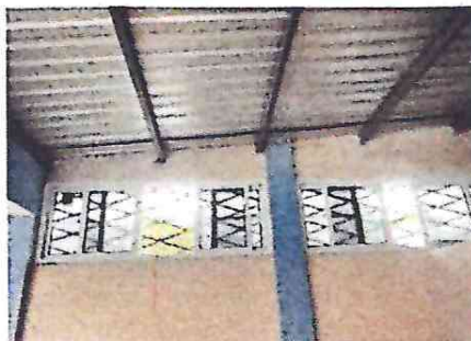
Foto 2: filtración de agua en paredes por deterioro de concreto entre juntas de laminas.
