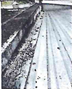
Foto 1: Deterioro de concreto entre junta de lámina con pared, (foto tomada de lado sur a lado norte).
