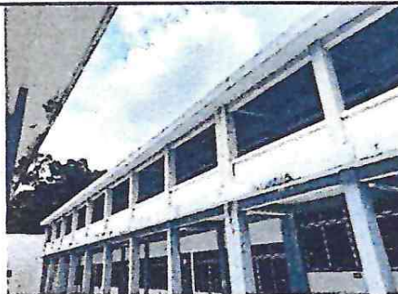
Foto 8: falta de bajadas de agua pluvial para evitar colapso en el techo ala sur del establecimiento.
