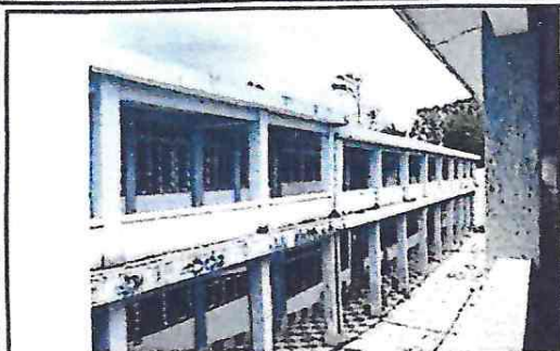
Foto 7: falta de bajadas de agua pluvial para evitar colapso en el techo ala norte del establecimiento.
