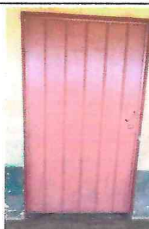
Foto 4: Pintura de la dirección en mal estado, material no adecuado.
