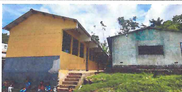
Foto 5: Pintura deteriorado módulo 1 y 2 en mal estado.
