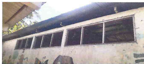
Foto 2: Balcones en mal estado, estructura de metal deteriorado.
