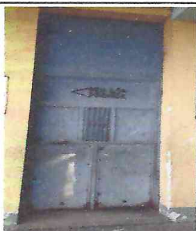
Foto 3: Pintura y chapas en la puerta mal estado.
