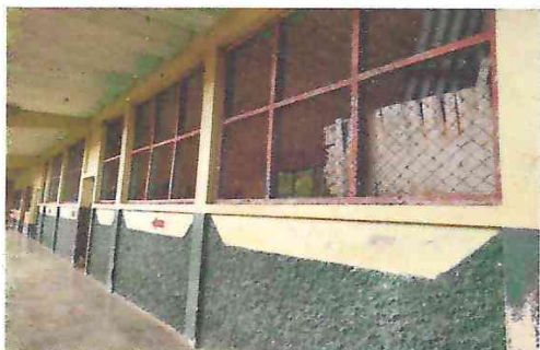
Foto 1: Balcones en mal estado, estructura de metal deteriorado.
