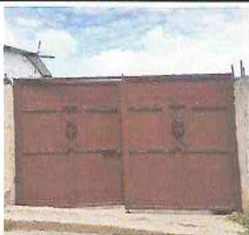
Foto1: Sustrucción de puerta principal acceso a párvulos.
