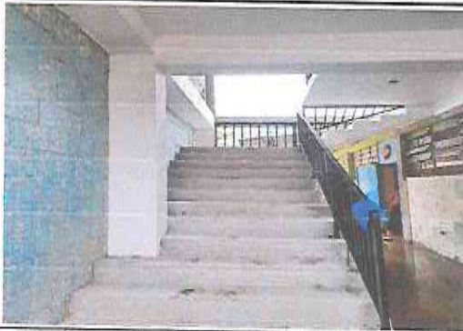
Foto 3: Sustrucción de puerta principal módulo 3 por gradas y barrandas.
