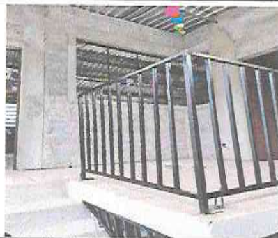
Foto 2: Sustrucción de puerta por colocación de barrandas,
