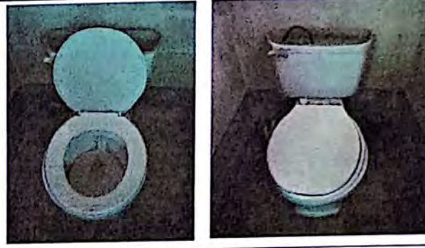
Foto 8: Servicio sanitario en mal estado
