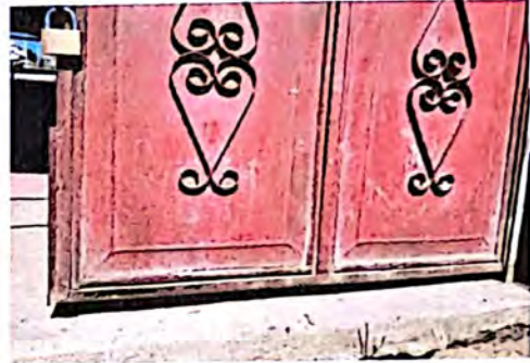
Foto 2: portón en mal estado
