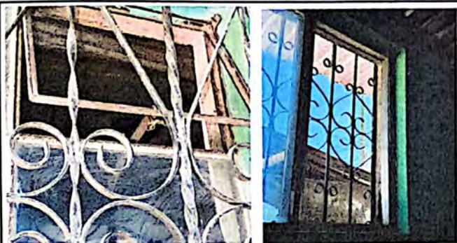
Foto 7: Ventanas en mal estado
