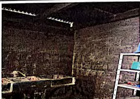
Foto 10: Pared en mal estado
