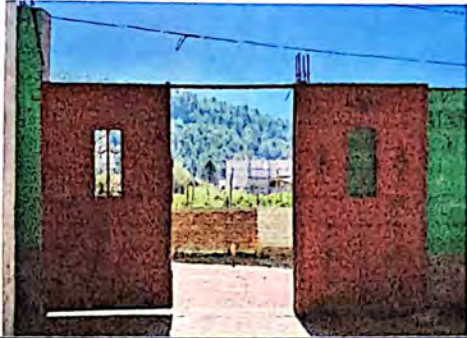
Foto 1: portón en mal estado
