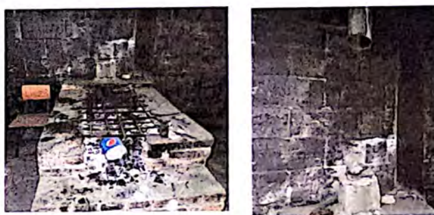
Foto 9: Estufa y chimenea en mal estado
