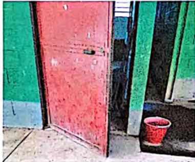
Foto 3: puerta en mal estado
