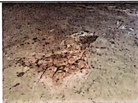
Foto 11: Suelo de cocina en mal estado
