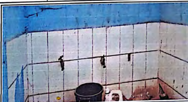
Foto 8: Chorros de lavamanos en mal estado
