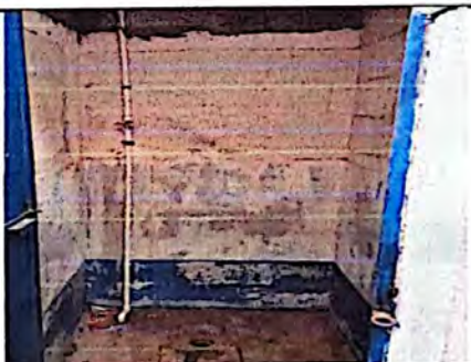
Foto 5: Paredes del baño está en mal estado
