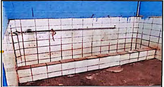
Foto 2: Baño de hombres en mal estado
