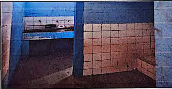
Foto 14: Azulejo en los baños en mal estado
