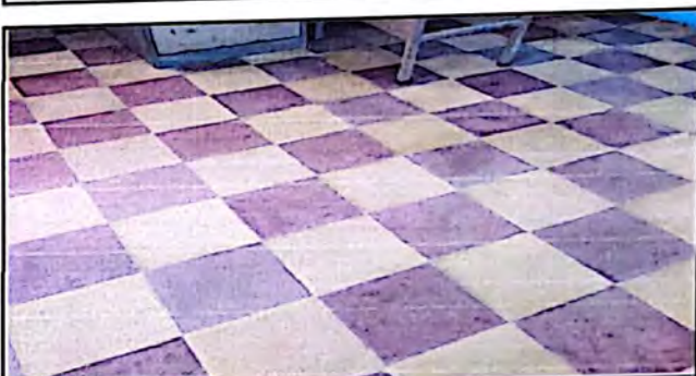
Foto 10: Piso en dirección en mal estado
