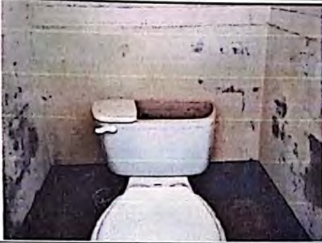
Foto 1: Tazas y accesorios en mal estado
