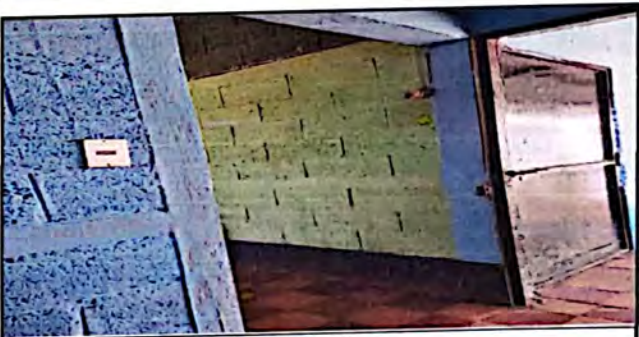
Foto 12: Falta de puerta interna a bodega
