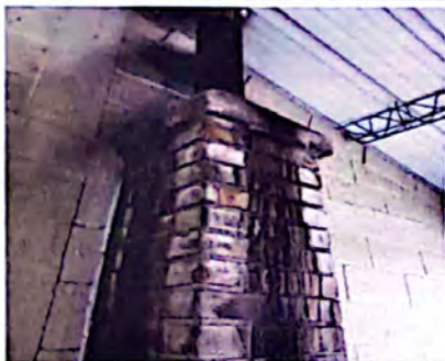
Foto 1: Chimenea de la cocina en mal estado
