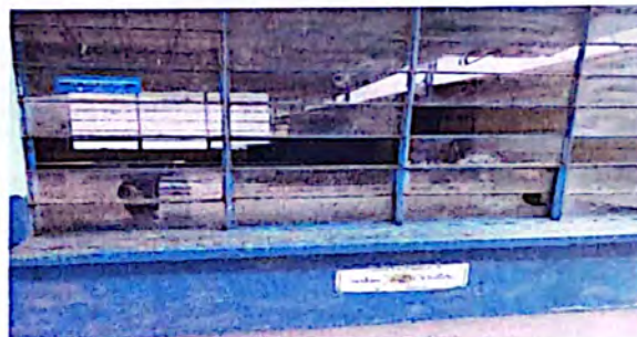
Foto 2: Ventanas rotas y en mal estado
