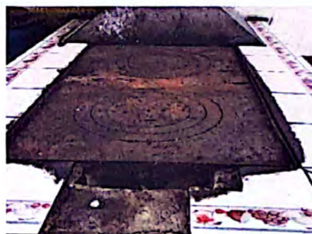
Foto 4: Plancha y el poyo de la cocina en mal estado
