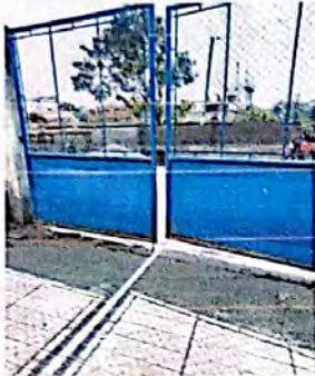
Foto 1: Deterioro de metal en la parte inferior del portón.
