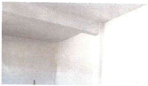
Foto 1: Cernido en pades de muro perimetral.
