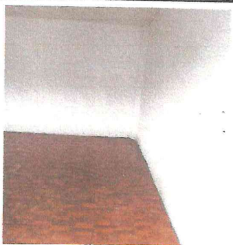
Foto 3: Cernido en pades de muro perimetral.
