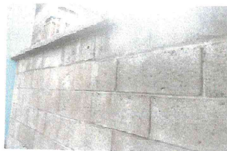
Foto 2: Se necesita reparación de muro perimetral del block
