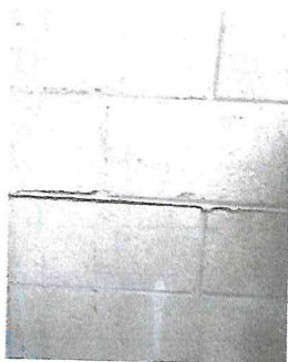
Foto 1: Se necesita repellar en muros de paredes de muros perimetrales.
