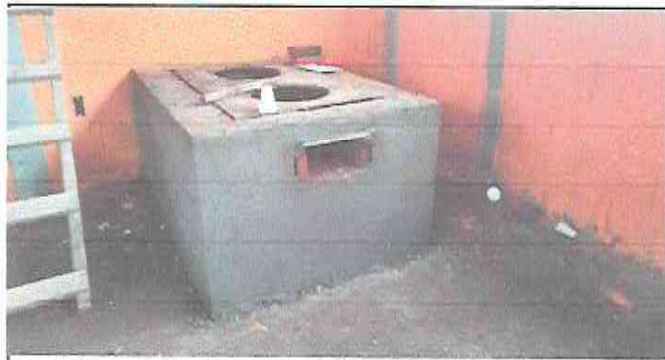
Foto 3: Mantenimiento de estufa rural (completo) incluye chimenea y plancha de metal
