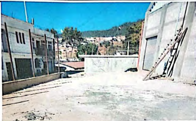
Foto 1: Torta de Cemento en el Patio.
