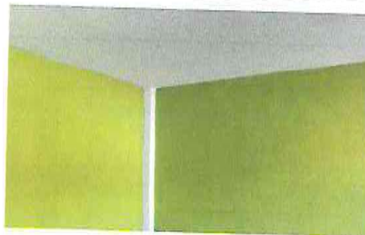
Foto 4: Pintura en mal estado interiores y exteriores.
