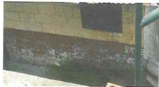
Foto 4: Pintura en mal estado interiores y exteriores
