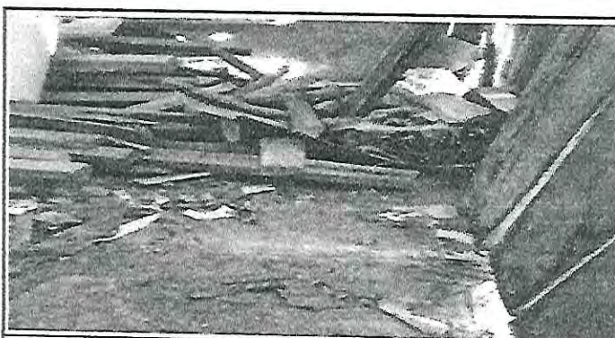
Foto 5: pavimentacion de patio de recreaciones llenos de escombros
