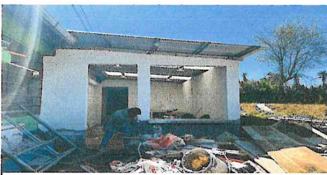
Foto 5: Sustitucion área de cocina, por material de plástico que no es apto para la cocina y evitar incendios.
