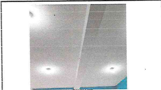
Foto 1. Lamparas instaladas al 100% en las aulas
