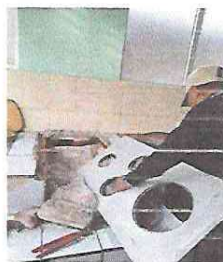
Foto 3: La plancha tiene varias grietas que generan humo dentro de la cocina y genera contaminación a los al.
