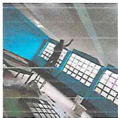
Foto 1: Actualmente se cuenta con lámparas de neón quebradas y defectuosas, se hará una nueva red de instalación eléctrica para focos led, para ahorrar energía y mas facilidad de cambio.
