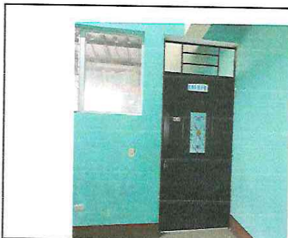
Fotos 7: Las puerta actualmente no cuentan con regía para resguardar los artículos de la dirección.
