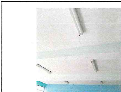
Foto 1: Actualmente se cuenta con lamparas de neón quebradas y defectuosas, se hará una nueva red de instalación eléctrica para focos led, para ahorrar energía y mas facilidad de cambio.
