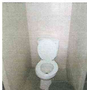
Foto 4: Se cambiara un sanitario que se encuentra en mal estado, se cambiara los pedestal del lavamanos y se colocará a una altura adecuada para los niños.
