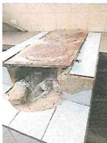
Foto 3: La plancha tiene varias grietas que generan humo dentro de la cocina y genera contaminación a los alimentos y para la cocineras.
