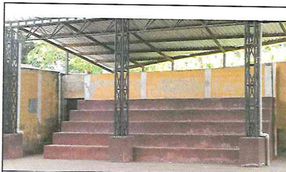
Fotos 8: Actualmente no se cuenta con una malla para evitar que los niños puedan saltar hacia afuera del centro educativo.
