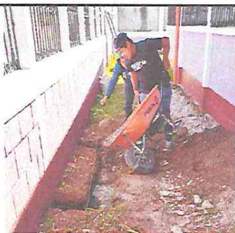
Foto 3: losa de patio, botar la acera que esta deteriorada y hacer una losa corrida para el corredor
