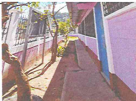
Foto 3: losa de patio, botar la acera que esta deteriorada y hacer una losa corrida para el corredor
