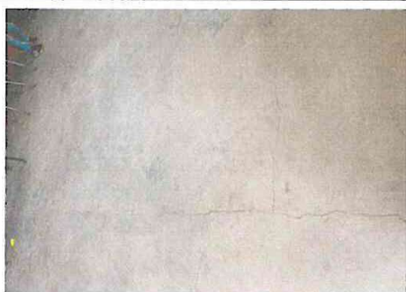
Foto 1: piso en mal estado.
