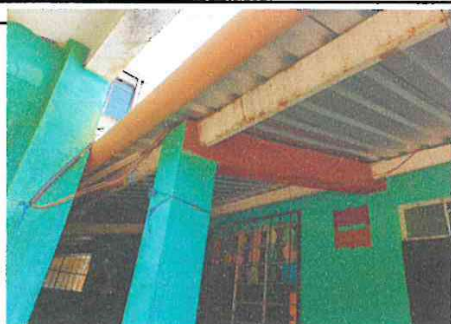
Foto 4: cables en mal estado y necesita cambio en toda las aulas.
