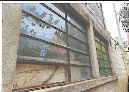
Foto 6: vidrios quebrados de varias ventanas y sin balcon.
