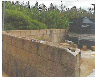
Foto 2: muro perimetral necesita malla para seguridad de agua tinaco de la escuela.
