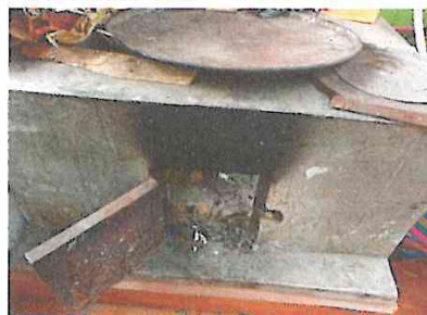
Foto 5: Estufa en mal estado.
