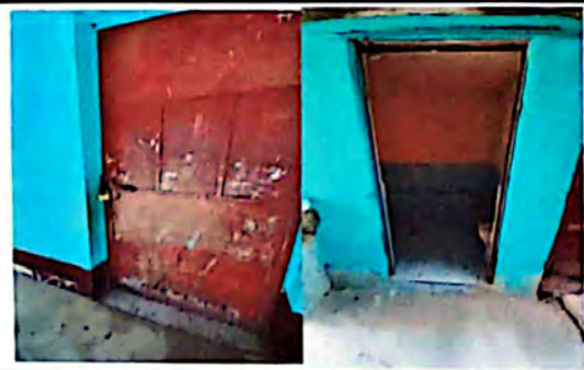
Foto 5: Puertas y chiapas en mal estado
