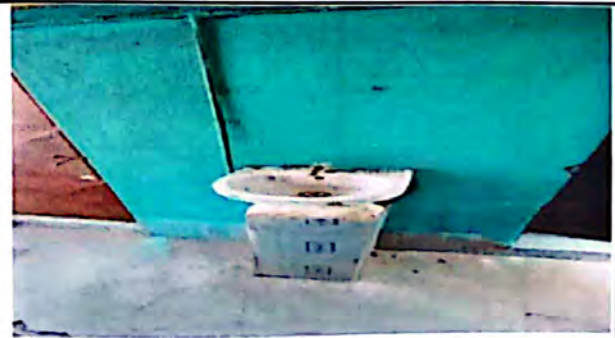
Foto 6: Lavamanos en mal estado
