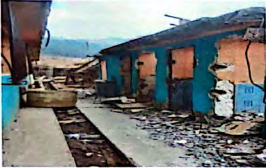
Foto 1: Baños en mal estado
