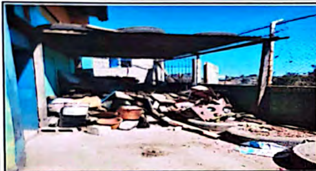
Foto 1: Área de cocina en mal estado.
