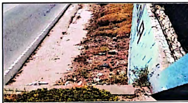
Foto 6: Deterioro de área principal
