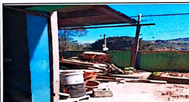
Foto 3: Paredes sin terminación en área de cocina
