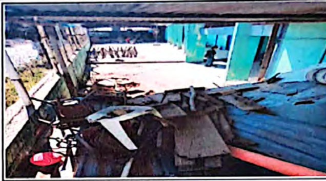
Foto 2: Falta de pared frontal de cocina
