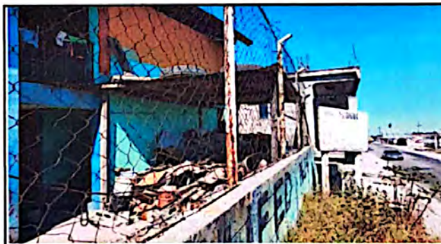
Foto 4: Techado en mal estado en área de cocina
