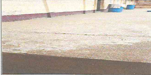
FOTO 2: Piso de concreto en malas condiciones.
