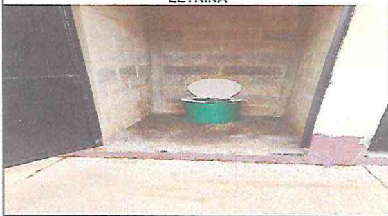
FOTO 1: Letrina en mal estado.
