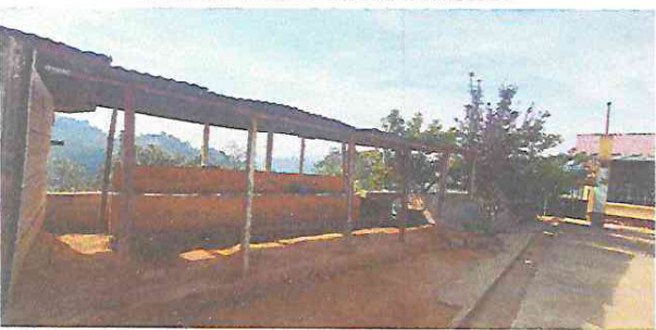
Foto3: Estructura del techo de lavamanos deteriorado.
