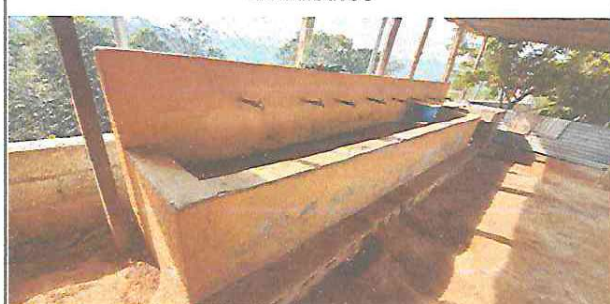
Foto 4: Lavamanos en mal estado.
