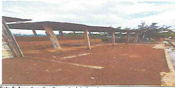
Foto 5: Área de patio altamente deteriorado
