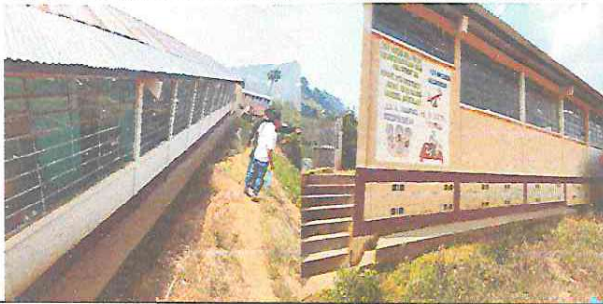
FOTO 1: Pintura de muros exteriores e interiores de la escuela en malas condiciones.
