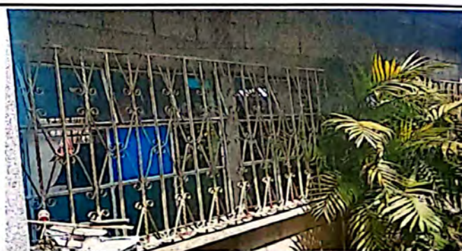
Foto 6: Balcones en mal estado y oxidados
