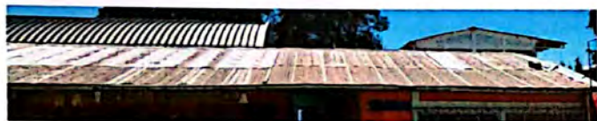
Foto 1: laminas en mal estado, techo y pared
