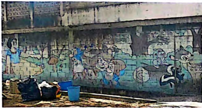
Foto 7: Paredes en mal estado.
