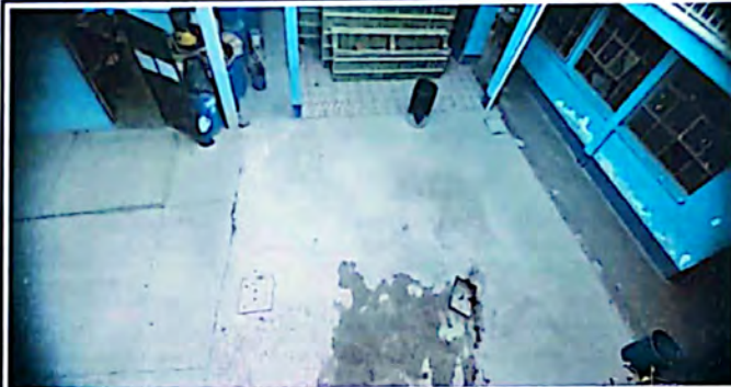
Foto 2: El patio cívico necesita mantenimiento
