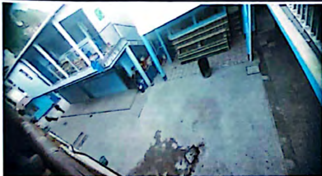
Foto 1: El patio cívico necesita mantenimiento
