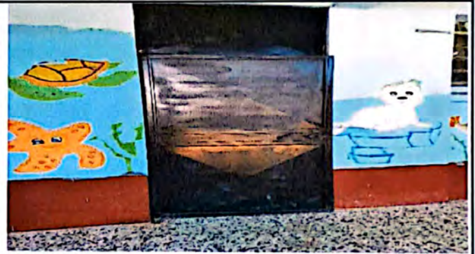
FOTO 4: Puertas y chapas en mal estado.
