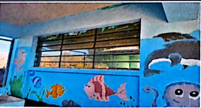
FOTO 5: Barrandas en malas condiciones.
