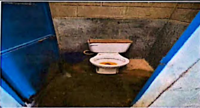
FOTO 3: Inodoro en malas condiciones.
