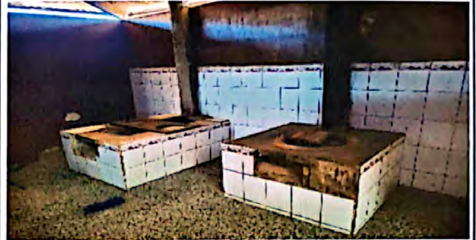
FOTO 2: Estufas de leña en malas condiciones.
