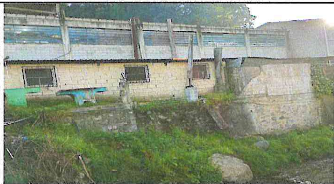
Foto 1: Cerco en mal estado
